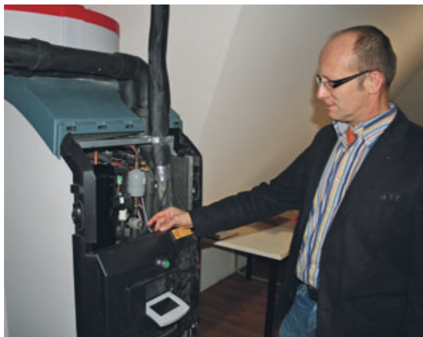
Jan Geurt Hupkes naast het gecombineerde warmtepomp- en zonneboilersysteem van Solvis dat hij installeerde in een woning in Tweede Valthermond.
