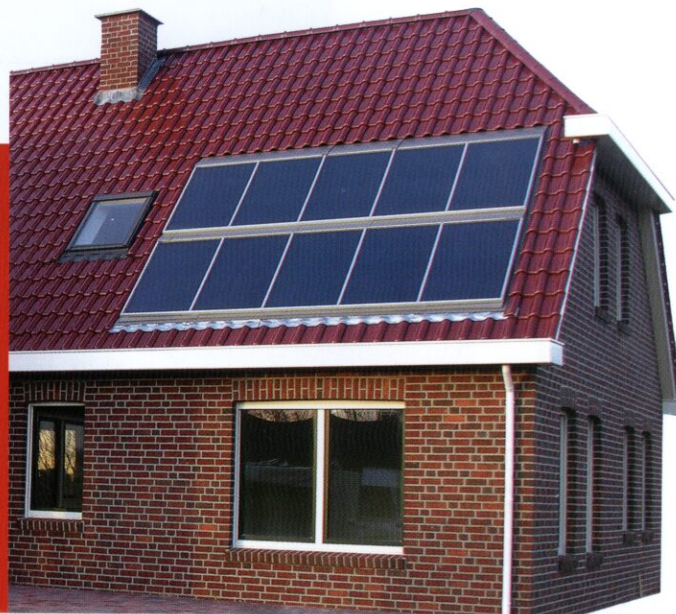
Nieuwbouwwoning in Tweede Valthermond met één van de eerste warmtepomp-zonneboilercombinaties in Nederland (6 kW).
